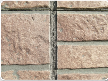
シーリングの劣化
